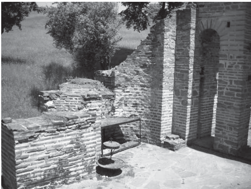
Сл. 11. Богородичина црква, призидана база носеће конструкције у североисточном углу наоса Fig. 11. Church of the Virgin, added base of the supporting construction in the northeast corner of the naos
