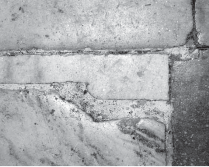
Сл. 3а. Сџуденица, главна црква, исџуна у исџоном лежишџу уз југозајадни носач куџоле Fig. 3a. Studenica, main church, infill in the east hole next to the southwest dome-supporting pilaster
