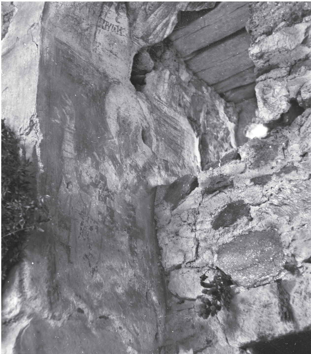
СЛ. 15. ИСТОЧНА СТРАНА СЕВЕРОИСТОЧНОГ СТУПЦА И ДЕО ДОЗИДАНЕ ОЈАЧАВАЈУЋЕ КОНСТРУКЦИЈЕ, СТАЊЕ ИЗ 1968
