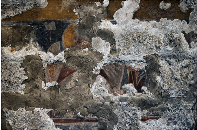
Сл. 3 Фрагменти попрсеја на јужном делу свода Fig. 3 Fragments of busts on the southern part of the vault
